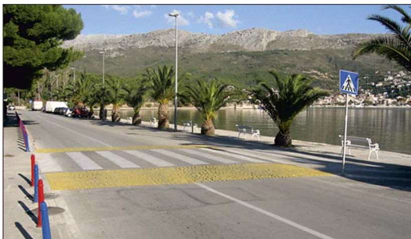
Slika 20. Uzdignute plohe za smanjenje brzine s obilježenim pješačkim prijelazom i obojenim prilaznim rampama od drugačijeg materijala
